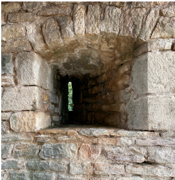
Fig. 13 : Archère à allège, en fente simple. Traces d'humidité, développement biologique et d'efflorescence.
