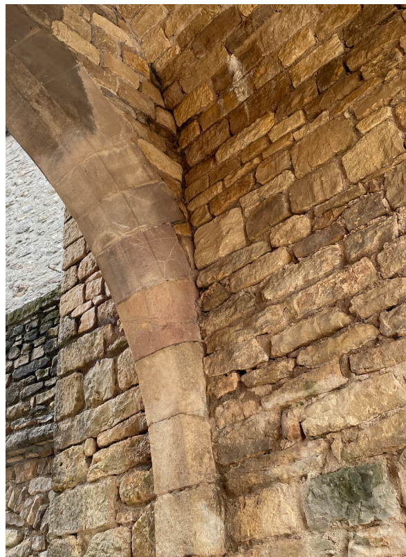
Fig. 22 : Parement humide entre l'arc nord et le parement est.
