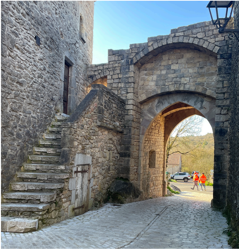
Fig. 5 : Vue de l'élévation nord. Noircissement des pierres et traces d'humidité.
