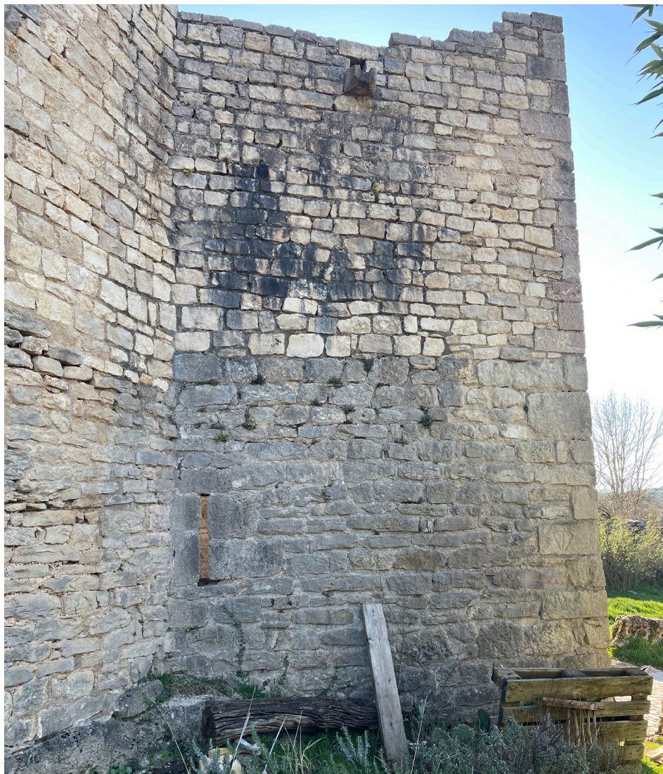
Fig. 10 : Vue de l'élévation ouest. La partie supérieure, reconstruite en 2006, présente une intégration peu harmonieuse. Noircissements liés à une colonisation biologique.
