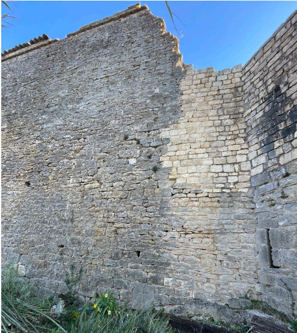
Fig. 23 : Vue de la courtine attenante à l'ouest de la tour. La partie supérieure, reconstruite en 2006, présente une intégration peu harmonieuse.
