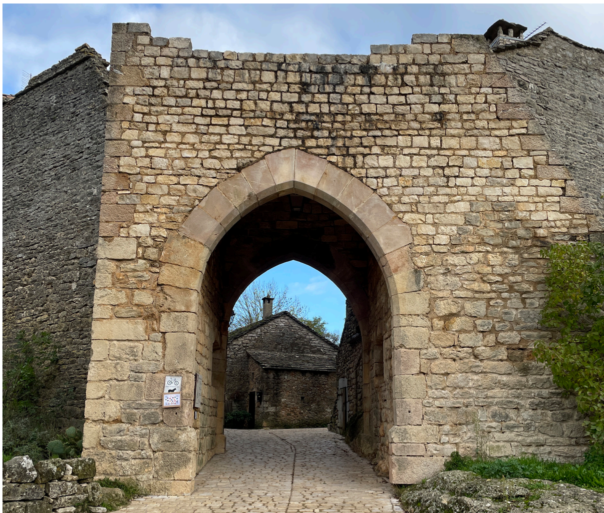
Fig. 3 : Vue de l'élévation sud de la porte. La partie supérieure, reconstruite en 2006, présente une intégration peu harmonieuse. Noircissements liés à une colonisation biologique.
