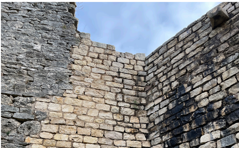
Fig. 24 : Forte disparité entre le parement ancien et la reconstruction de 2006. Noircissements liés à une colonisation biologique.
