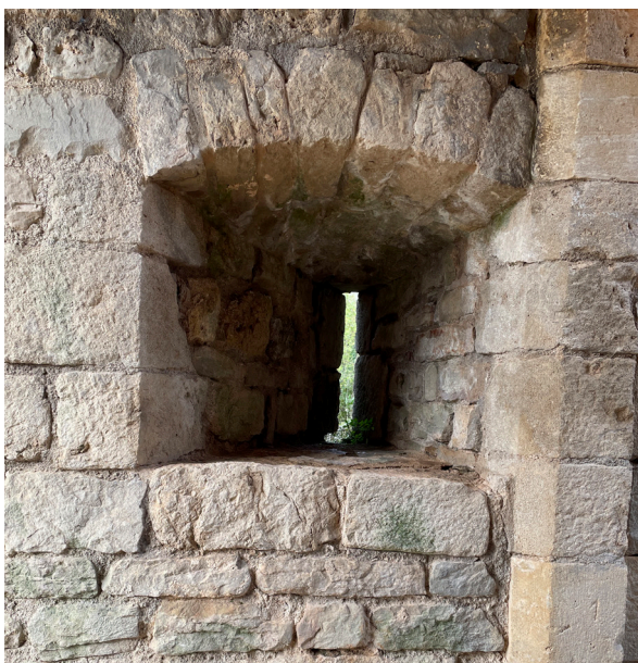
Fig. 16 : Archère à allège, en fente simple. Traces d'humidité, développement biologique et d'efflorescence.
