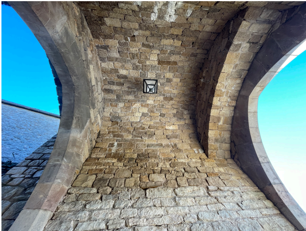
Fig. 20 : Vue de la voûte. Parement humide et présence d'un encroûtement de calcite en partie supérieure.
