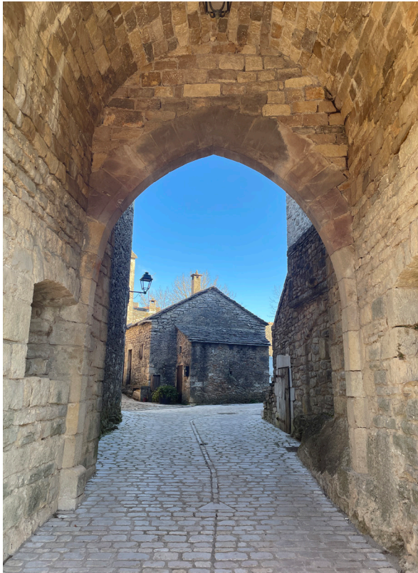
Fig. 18 : Vue de l'élévation intérieure, au revers de la face nord. Parement humide en partie supérieure.
