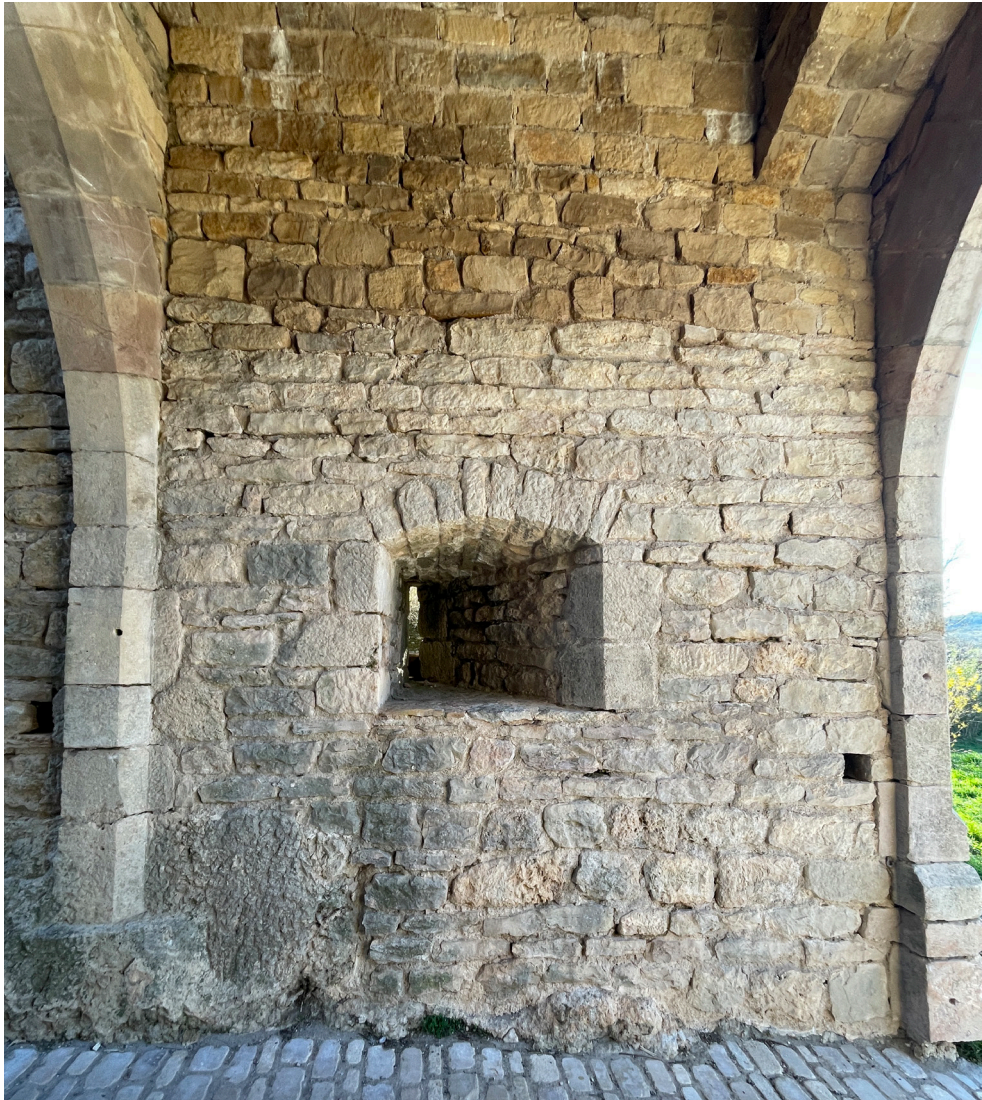
Fig. 12 : Vue de l'élévation intérieure, au revers de la face est. La partie supérieure, reconstruite en 2006, présente une intégration peu harmonieuse.
